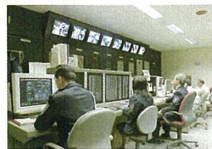
防災センター
